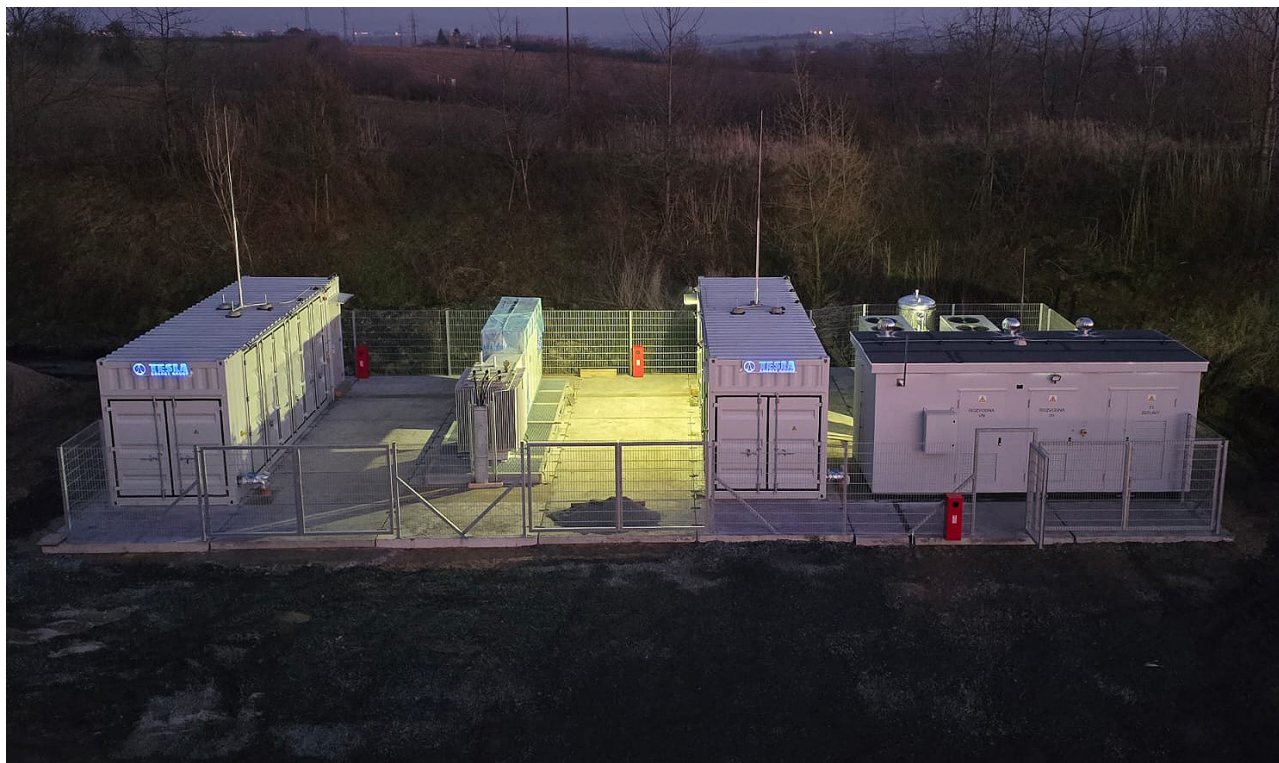
Kapalinou chlazené bateriové úložiště Gama 233 (každá technologická skříň má 100kW výkon a 233kWh kapacitu). Na baterie je napojena fotovoltaika a baterie balancuje výrobu se spotřebou.
