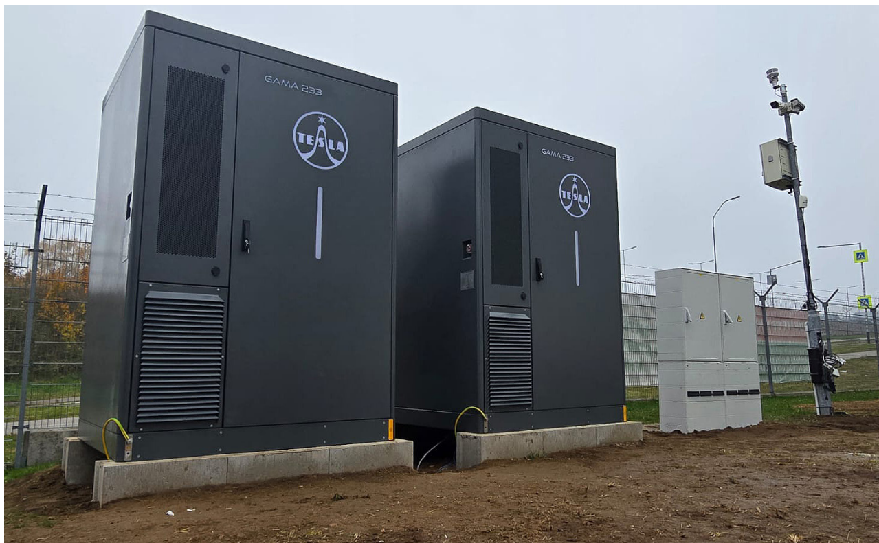
Bateriové úložiště v areálu ČKD Kutná Hora. Jde o velmi specifické úložiště s výkonem 4 MW a kapacitou 4,5 MWh, tedy 1C systém.
